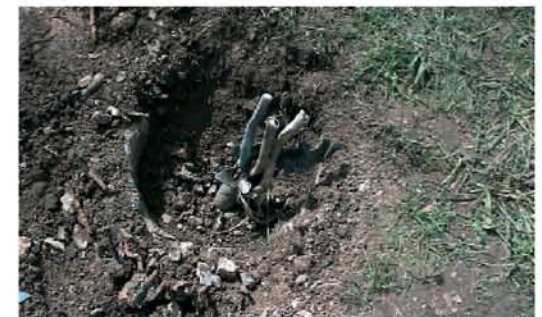
Abgetrenntes Erdkabel unter Spannung
