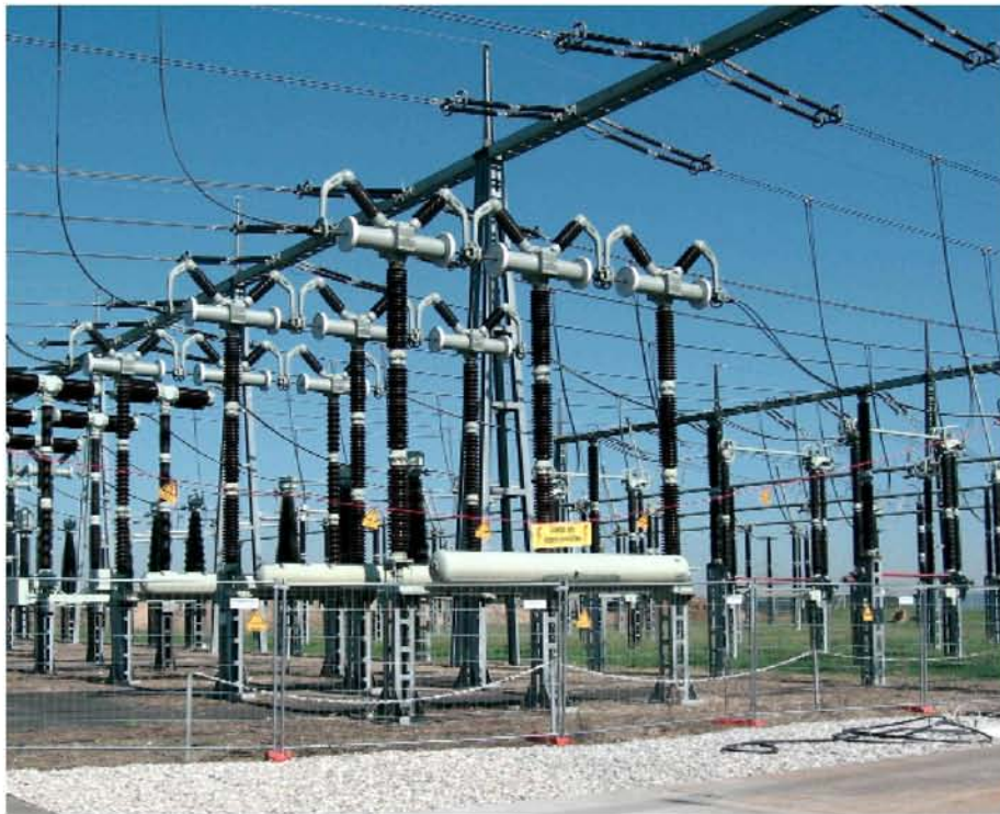
Leistungsschalter in einem 380 kV-Schaltfeld
