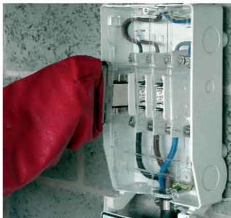
Hausanschlusskasten mit Niederspannungs-Hochleistungssicherungen (NH-Sicherungen)
