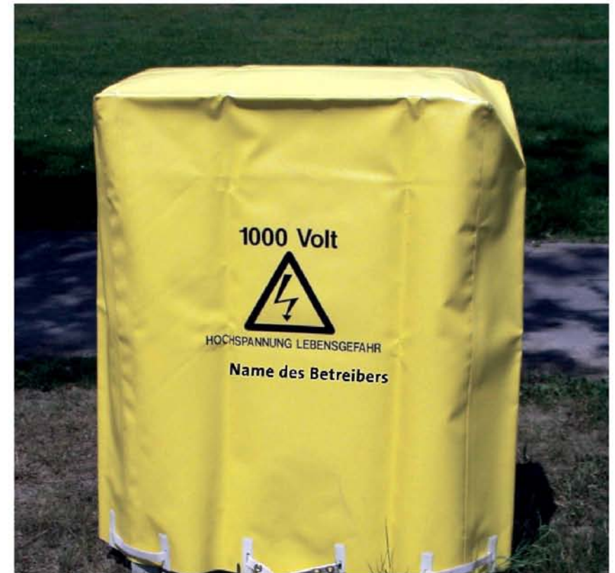
Beschädigter Kabelverteilerschrank isolierend abgedeckt
