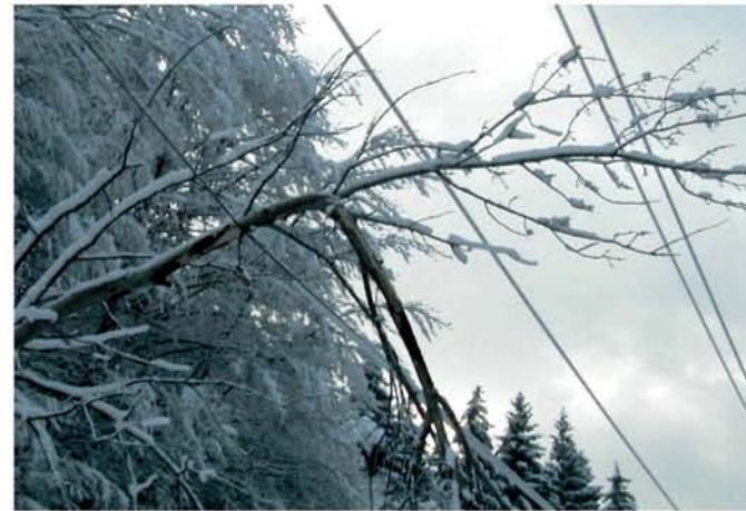
Äste in 110 kV-Freileitung
