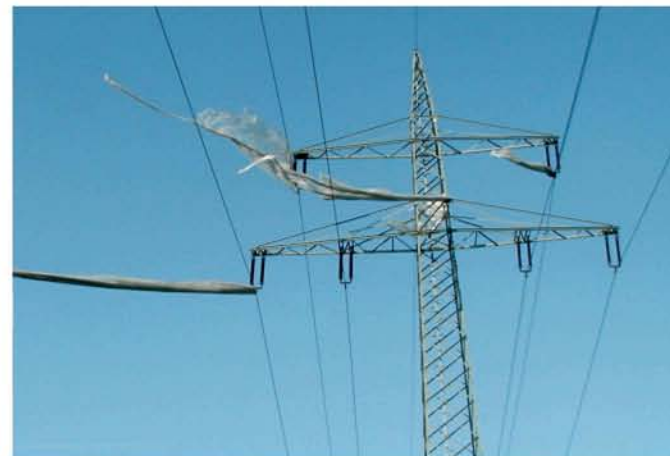
„Spargelfolie“ in 110 kV-Freileitung
