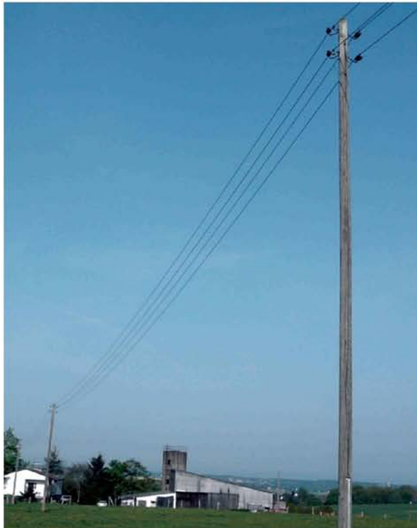
Masthöhe ca. 8 – 12 m Niederspannungsfreileitung
